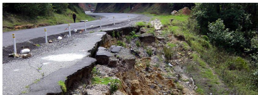
Figura 10 Vía dañada por una inundación en Guatemala. Foto por Gunter Zietlow, 2001, GTZ
